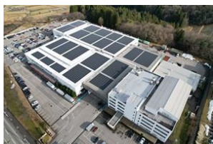
太陽光発電設備（屋上部） 富山事業所
